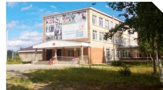
выполнение работ по устройству бетонного основания спортивной площадки в МБОУ «Игримская СОШ № 1».
